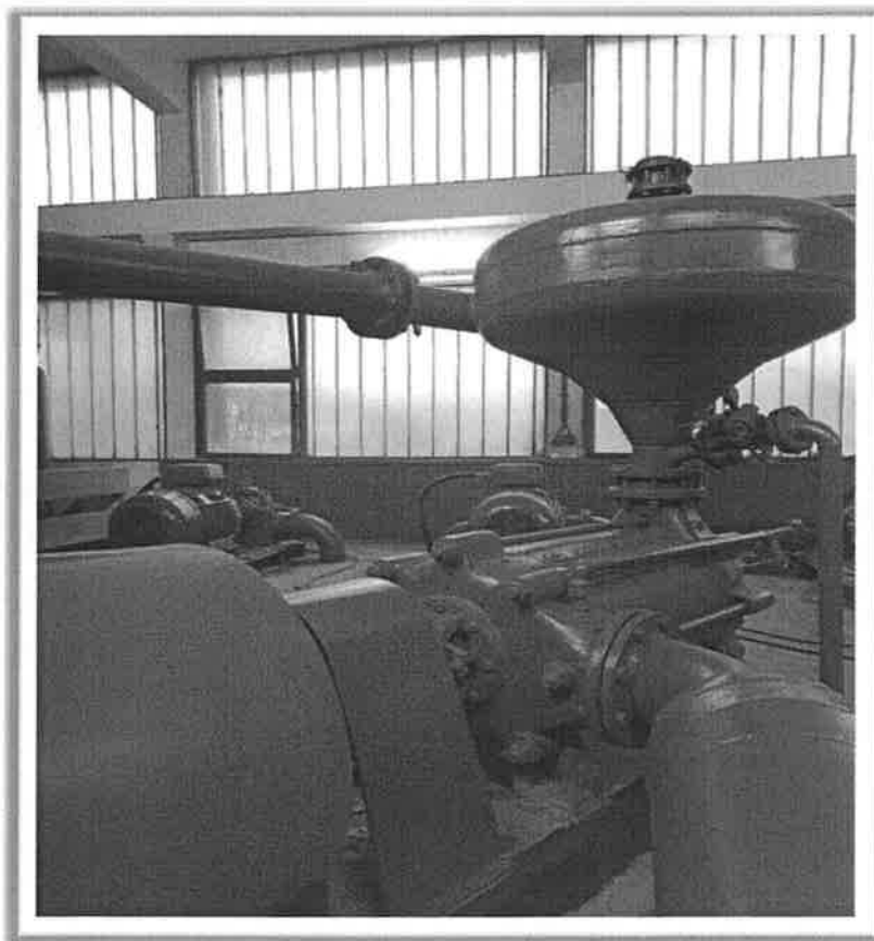
Slika 7. Instalirani novi pumpni agregat smjer Ši Selo
