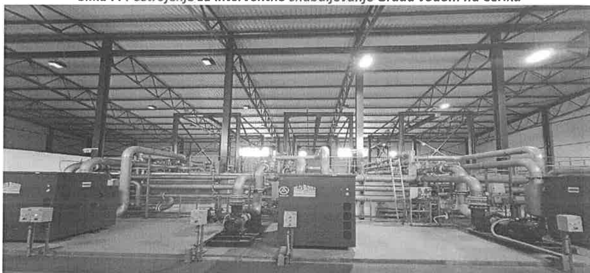
Slika 8. Unutrašnjost postrojenja u Ceriku
